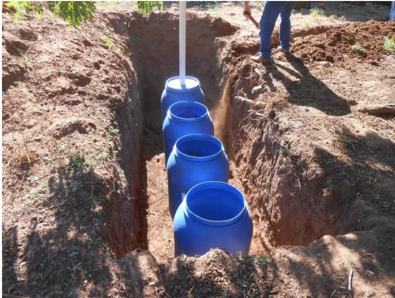
Figura 08: Fossas com filtros biológicos
